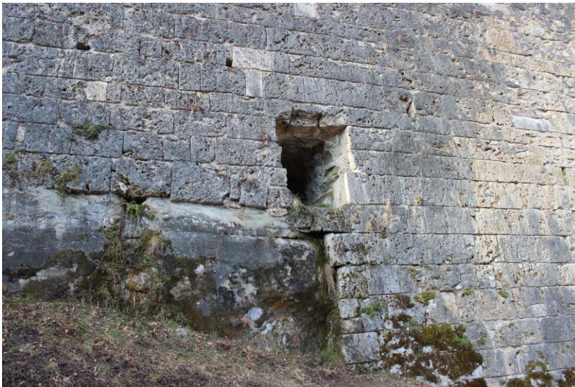
Abbildung 48: Schatzgräberloch in Schildmauer (Quelle: eigene Fotografie, 2020)
