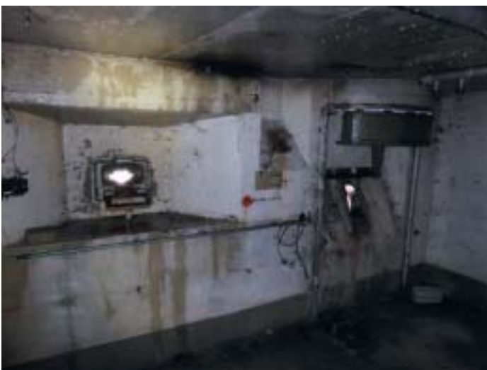
Photo 4 : les trous de tir ne constituent a priori pas des accès appréciés par les chauves-souris; ils sont trop petits pour un accès en vol. Fort des Gruyères, Gruyères.
