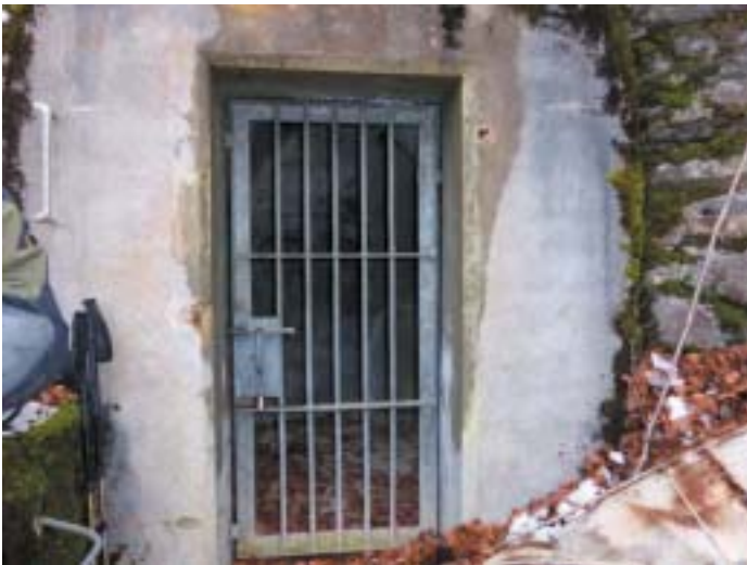
Photo 2 : les chauves-souris privilégient les accès en vol, ce que ne permet pas ce type de porte. Un aménagement simple permettrait d'y remédier. Fort de la Bérauta, Gruyères.
