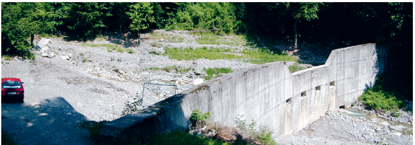
Abb. 3. Geschiebesammler Steinibach Dallenwil 1982–84. Foto: GHO-Geschiebemessnetz-Dokumentation.
