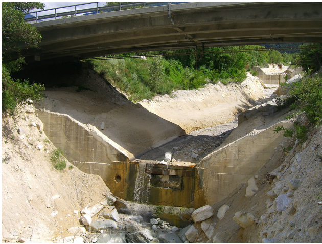
Abb. 6. Murgangwaage im Illgraben (VS) im Juni 2007 nach dem Durchgang eines Murganges. (Foto: F. Dufour)
