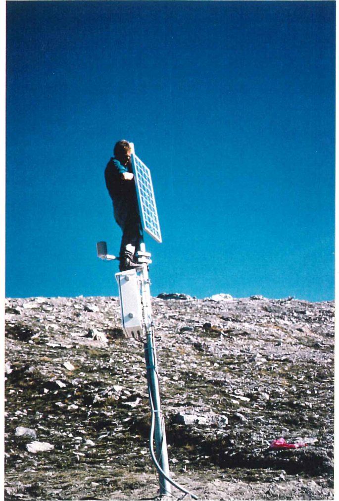
Photo 2 Klimastation mit Stahlblech-Gehäuse und Solar-Panel als Energieversorgung.
