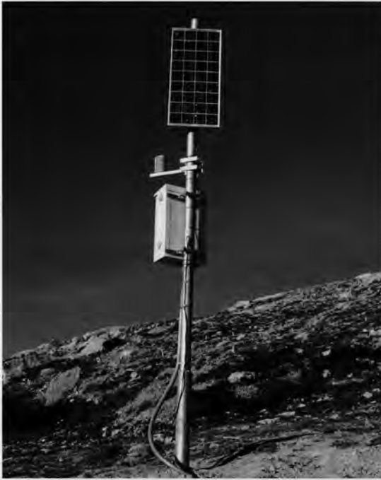
Abb. 2: Messmast mit Datenerfassungsgerät. Das Solarpanel versorgt die Klimastation mit Strom und Wärme.
