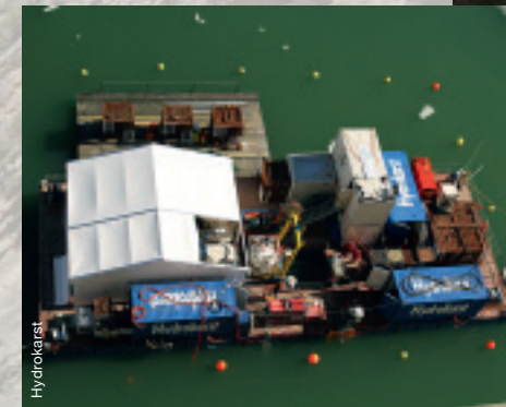
Abb. 2 Installationsplattform für Sättigungstauchen (Beispielbild)
