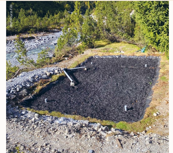
Die neue biologische Kläranlage verfügt nebst Wurmkompost über ein zusätzliches Pflanzenbecken, das 2022 bepflanzt wird und für die abschliessende Klärung sorgt.
