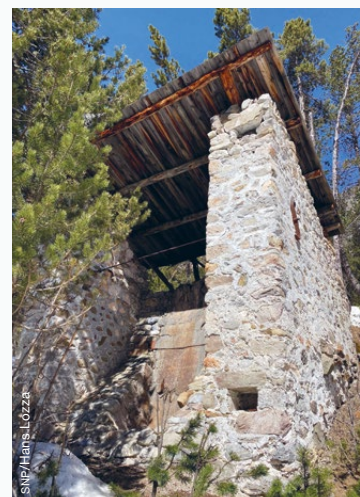
Abb. 2 Ruine eines Hochofens von 1684 bei Il Fuorn. Das Dach soll sie vor dem weiteren Zerfall schützen.
