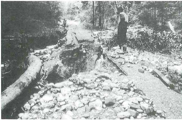
Bild 7. Walderschliessungsstrasse mit grösserem Längsgefälle nach dem 23. Juni 1993. Rechts oben ist ein Auflandungsdelta erkennbar, links ein Erosionstrichter im Strassenkörper mit neuem Bachgerinne.
