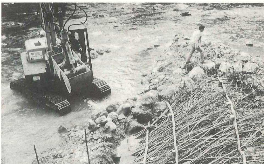
In Längsrichtung gesehen; ufernaher Teil mit Pfählen, Flechtwerk, Spreitlagen und Stecklingen geschützt (Oktober 1993).
